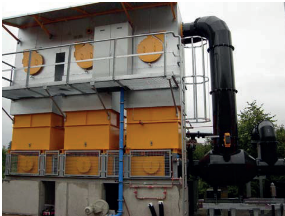
Abb. 2: Regenerative Nachverbrennungsanlage nach einer Biogasaufbereitung
